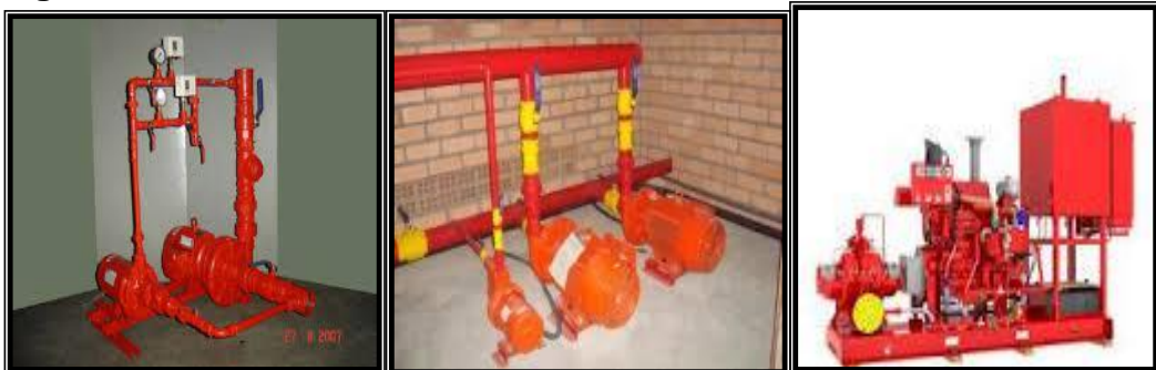
Figuras 22, 23 e 24: Bombas de Incêndio
