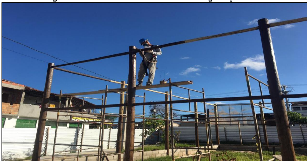
Figura 2: Trabalho em altura sem o cinto de segurança correto.
