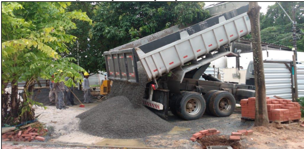
Figura 5: Depósito inadequado para Areia e Brita.
